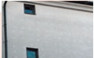
Dübelabzeichnung im Oberputz
