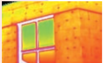
Thermographie mit Wärmebrücken durch Dübel
